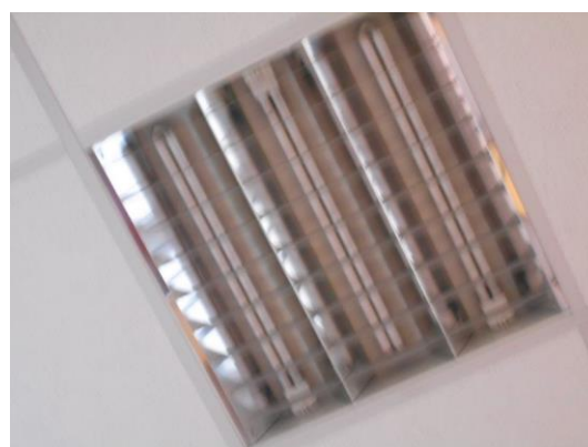
Figura 8.9 - Particolare di una plafoniera a tubi fluorescenti
