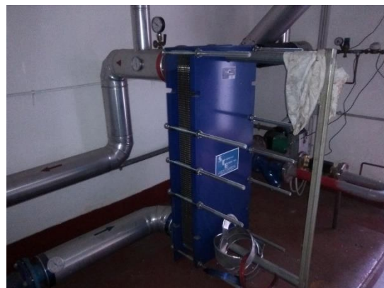
Figura 4.17 - Particolare dello scambiatore di calore
