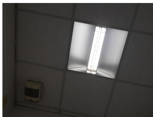
Figura 4.19 - Particolare dei corpi illuminanti ubicati nelle aule scolastiche
