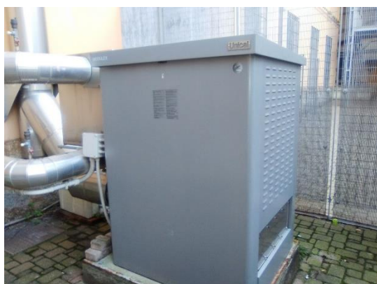
Figura 4.16 - Particolare della caldaia
