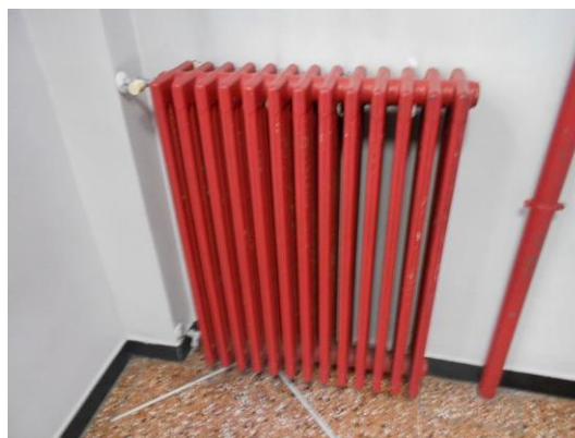
Figura 8.7 - Particolare di un radiatore senza valvole termostatiche
